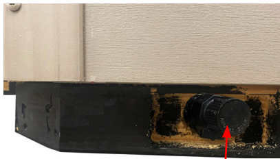
Tapa de desagüe
